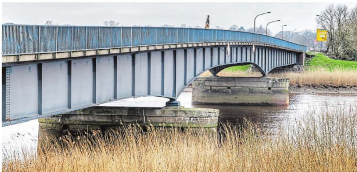
Bei der Ledabrücke sollen technische Anlagen künftig das Gewicht von Fahrzeugen scannen. Dafür stehen wieder Arbeiten und Sperrungen bevor. BILD: AXEL FRIES
