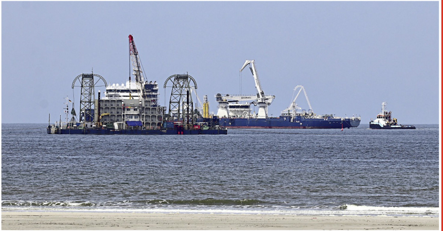
Der Kabelleger „Prysmian Marco Polo“ liefert im Hintergrund das Seekabel an, das mithilfe der „Barbarossa 1“ verteilt wird.
