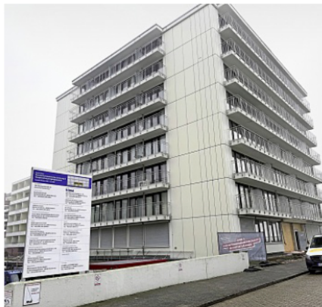
Eigentlich sollte der Kaiserhof nach der Endabnahme der Feuerschutzsanierung wieder zugänglich sein, aber die Wohnungsbesitzer warten noch immer. Foto: Volker Bartels
