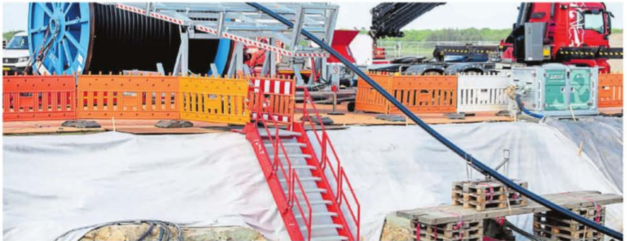
Großbaustelle: Auf mehreren Inseln und an der Küste werden Stromkabel zur Anbindung von Offshore-Windanlagen verlegt. Die oft weiträumigen Bauabschnitte betreffen zum Teil den Urlaubsbetrieb. Unser Foto entstand vor wenigen Tagen in Norden.
