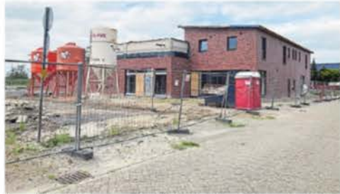
Baustelle des neuen Nah&Gut-Marktes für Jheringsfehn. Aufgrund der Insolvenz des Bauunternehmens kommt es hier zu Verzögerungen im Zeitplan. BILD: MAIKE HOFFMEIER
