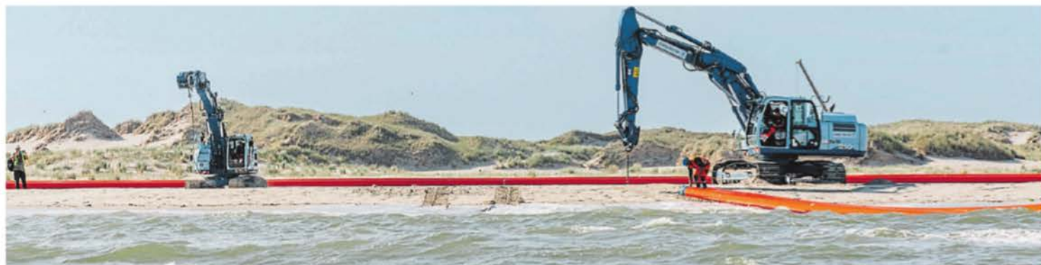
Zeitweise werden in diesem Sommer Strandabschnitte auf Norderney gesperrt: Amprion zieht neue Leitungen durch die Insel.
