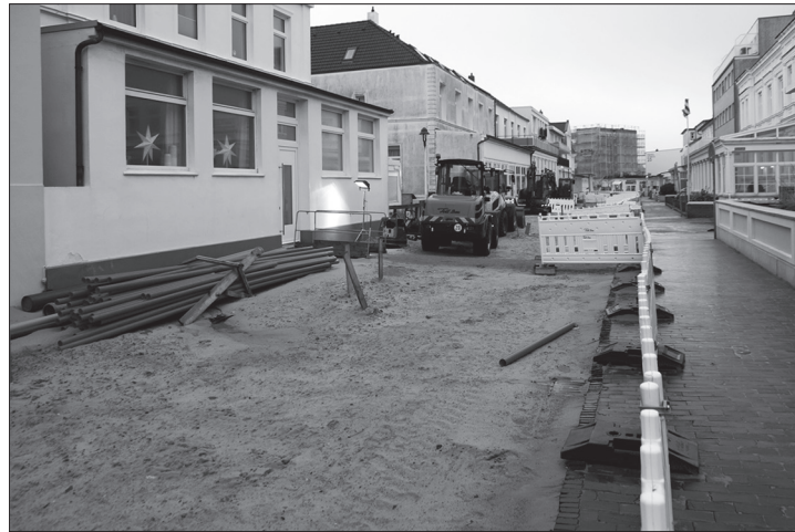
In der Moltkestraße liegen die Arbeiten für die Straßenerneuerung im Zeitplan. Bald können die Fußgänger auf die westliche Straßenseite wechseln. Foto: Linke
