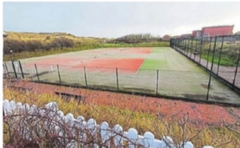
Die Tennisplätze auf Juist müssen saniert werden – doch das wird teuer.
